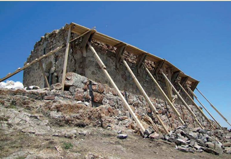
İşğal dövründə məbəddə qanunsuz təmir işləri aparılmış, dam örtüyü tamamilə yeni və müasir materiallarla qurulmuşdur.
